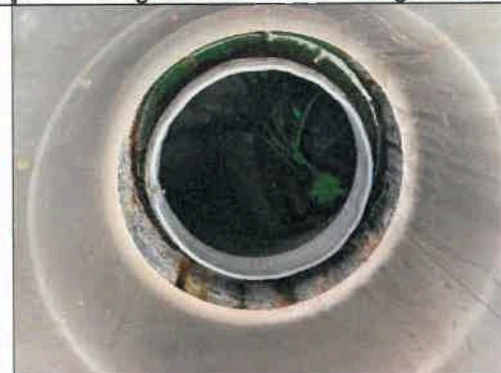
Bild 6: Infärgat vatten läcker in i ventilation ovan skadeplatsen via otätheter på tätskikt.
