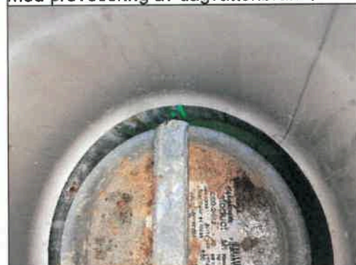
Bild 5: Infärgat vatten läcker in i ventilation ovan skadeplatsen via otätheter på tätskikt.
